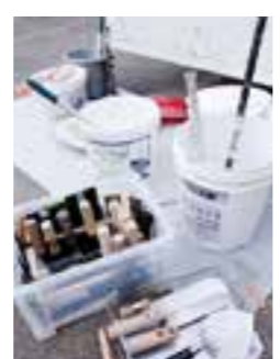
天然の漆喰に自然素材ののり、水を桶で混ぜ合わせ、材料を作る。自然素材の漆喰は割高だが、世の中が健康志向の今、ニーズが高いという
