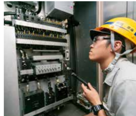
車両の様々な設備に電気を送る配電盤に異常がないか確認する
