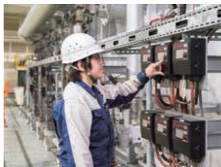
炉に取り付けられている計器を見て異常が検出されていないかチェックする
